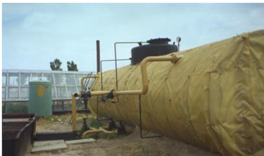
Рис. 1. Биогазовая установка с теплицей
